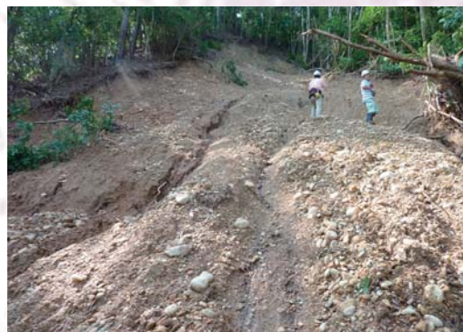
崩壊下部から上部を望む
