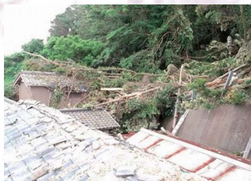
倒木により人家が破損
