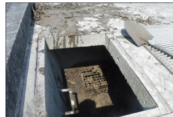
貯留施設内の堆積土砂
