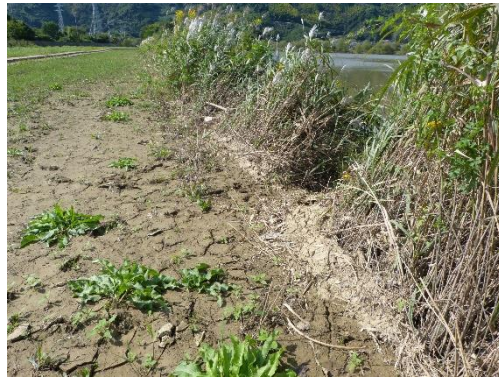
②陸域への土砂堆積の状況 (下池と七曲川の間 の越流堤)
