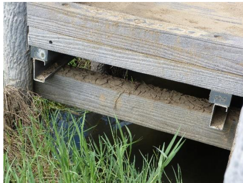
③陸域への土砂堆積、氾濫痕跡の状況 (上池)
