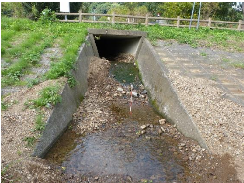
④流入水路からの土砂流入 (上池)
