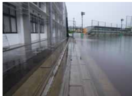
雨水貯留浸透施設の状況 (桜が丘高校 令和元年5月撮影)
