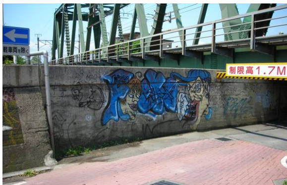
図 2-53 護岸への落書き -JR 橋付近-
