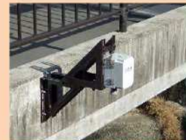
▲危機管理型水位計設置状況 (瀬名新川)
