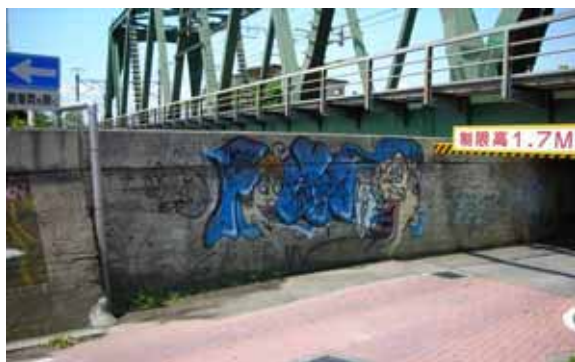
図 2-48 護岸への落書き -JR 橋付近-
