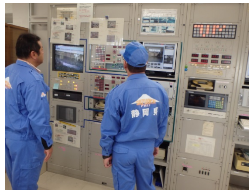
津波水門遠隔操作状況
