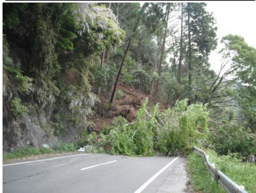
斜面崩落直後
