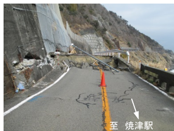
← 静岡市側の沈下状況 (1月30日)
