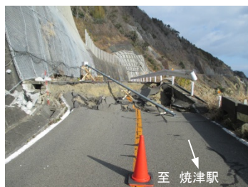
← 静岡市側の沈下状況 (1月7日)
