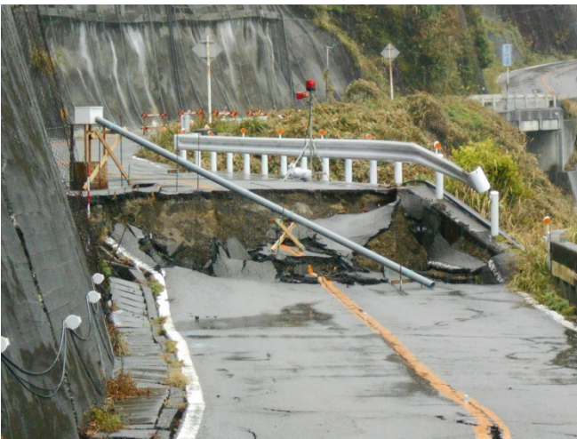
約1.5mの道路沈下 （11月現在）
