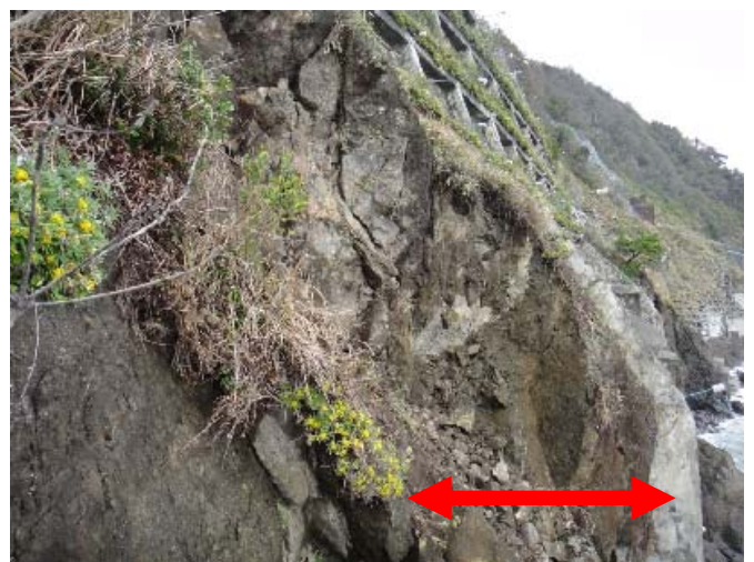
地すべりにより 海面付近斜面が押出されています （11月7日撮影）
