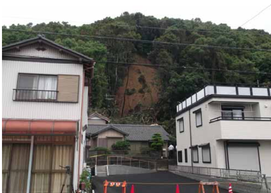
写真1 崩壊の状況(全景)
