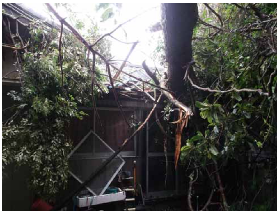
写真3 建物の被害状況
