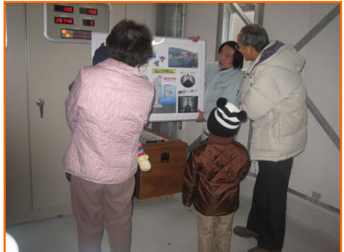
機械室（取水設備）（※普段は入れません）
