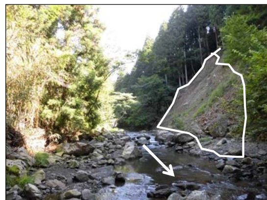
太田川ダム上流域の河岸における小崩壊地の事例
