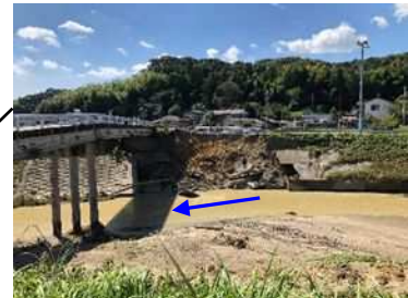
令和4年9月洪水 敷地川明治橋護岸損傷状況
