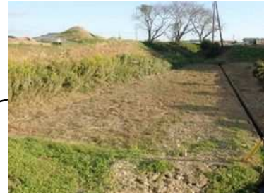
令和4年9月洪水 敷地川明治橋右岸下流浸水エリア
