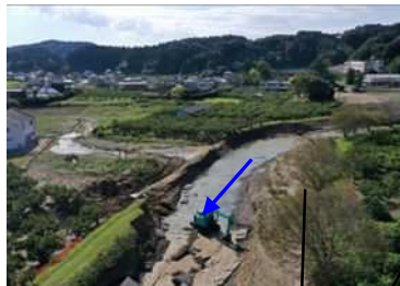
令和4年9月洪水 敷地川決壊箇所
