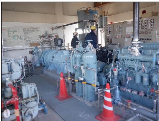
浜部排水機場
