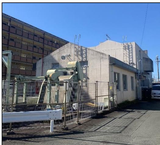
鳥之瀬排水ポンプ場
