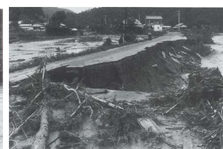
三倉川(森町黒石・県道袋井春野線) 昭和49年7月洪水による破堤写真
