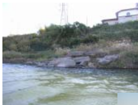
護岸損傷箇所
