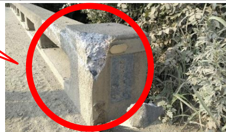
一部欠損した橋梁の親柱
