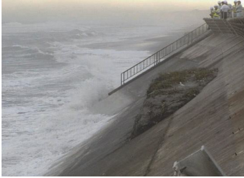
新居海岸（2002(H14)年8月） 台風に伴う高波浪により、国道1号バイパスの土台が露出しました。
